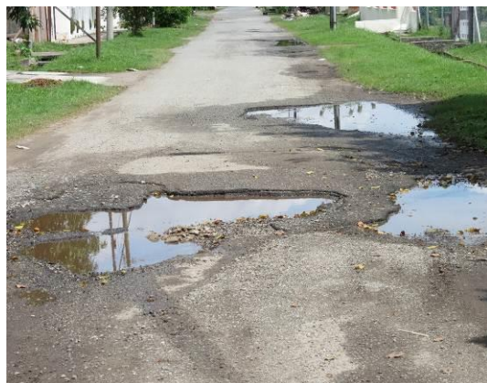
Gambar 2.3 Jalan Yang Mengalami Kerosakan
