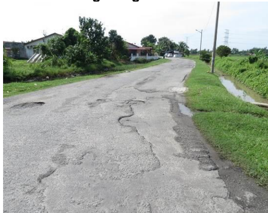
Gambar 2.2 Jalan Yang Mengalami Kerosakan
