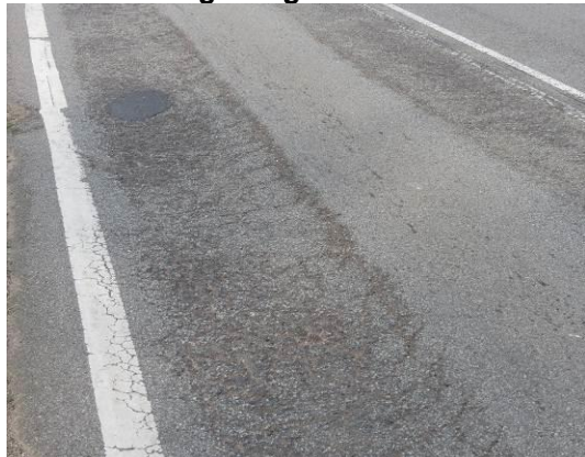
Gambar 2.1 Jalan Yang Mengalami Kerosakan
