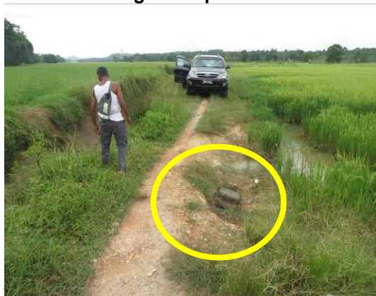
Gambar 2.6 Jalan Yang Diturap Telah Rosak
