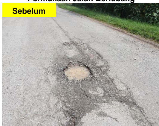
Gambar 2.17 Permukaan Jalan Berlubang
