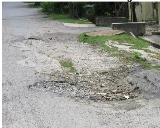
Gambar 2.15 Kerosakan Jenis Shoving
