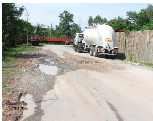
Gambar 2.16 Kerosakan Struktur Jalan
