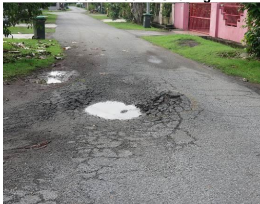
Gambar 2.14 Kerosakan Jenis Shoving
